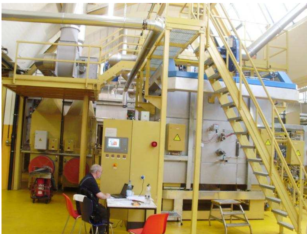
Instalatie pt procesare elemente de rulmenti de inalta precizie - Germania
